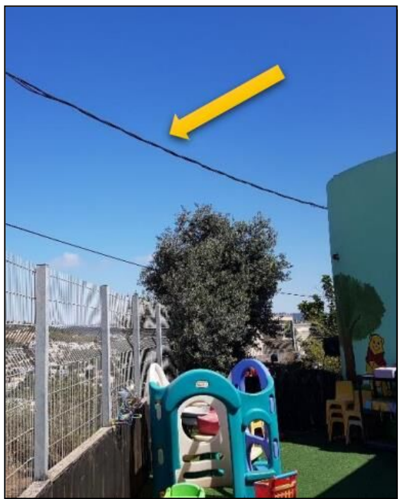
32. גן אלמסתכבל, דליית אלכרמל : כבל מתח נמוך עובר מעל לגדר הגן
